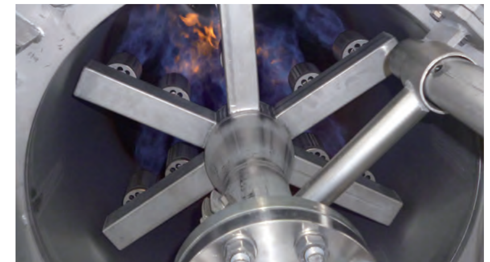
Pochodnia biogazowa z ukrytym procesem spalania
