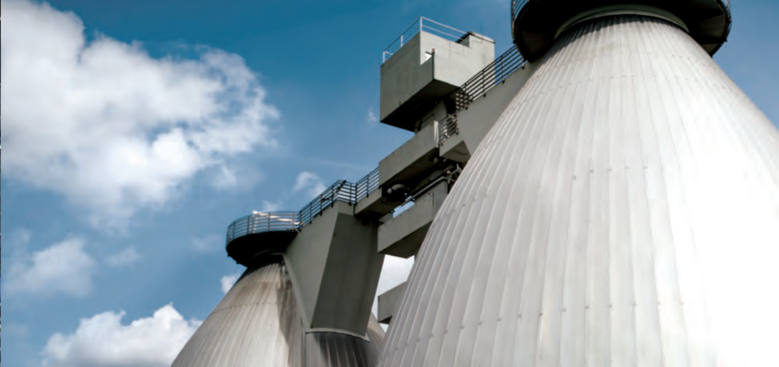
Oczyszczalnia ścieków Schwetzingen, Niemcy: Komory fermentacyjne do fermentacji i produkcji biogazu
