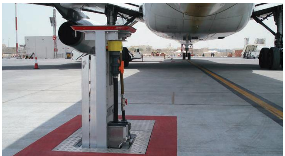
Internationaler Flughafen Bahrain (Foto: Cavotec): Komplett-Ausrüstung mit stationärem Ver- und Entsorgungssystem
